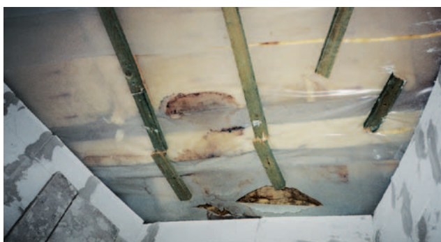
Poškození způsobené zkondenzovanou vodou
